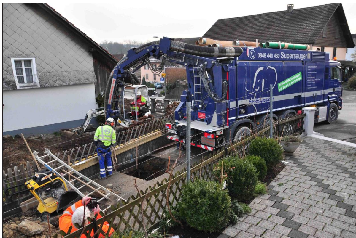
Saugbaggereinsatz Leitungsbruch Grienstrasse in Niederlenz
