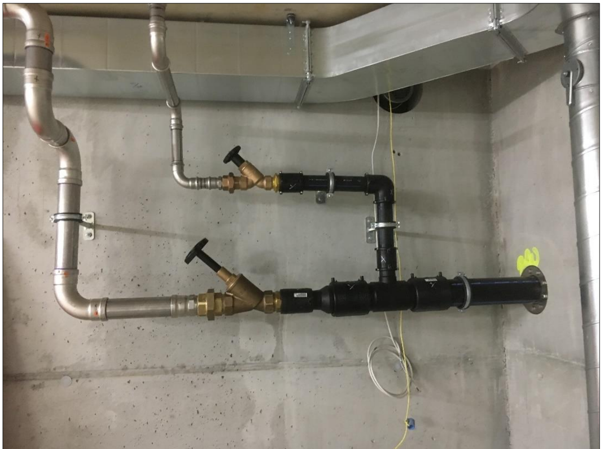
Hauseinführung MFH Bruggerstrasse in Wildegg
